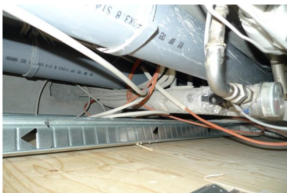
Billede fra installationsskakt ved bryggers.
