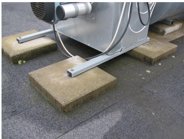
Her ses betonfliser som står direkte ned på tagpap.
