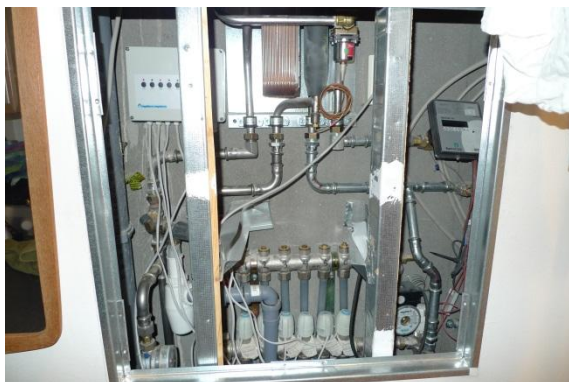
Her ses fra bryggers ind i installationsskakt.
