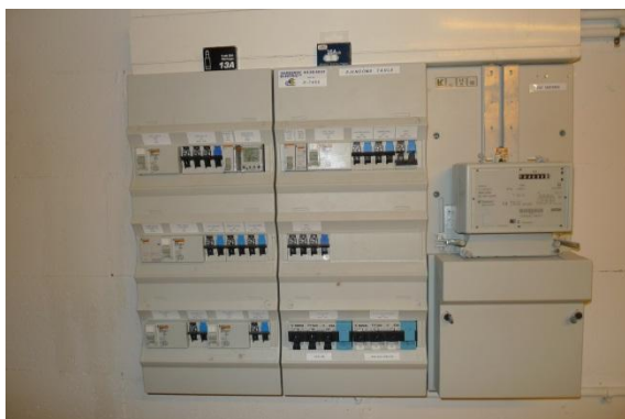
El-tavle placeret i varmecentral.
