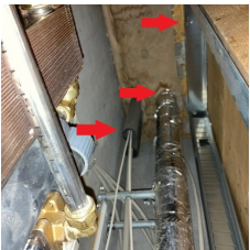
Gennemføring i teknikskakt.
